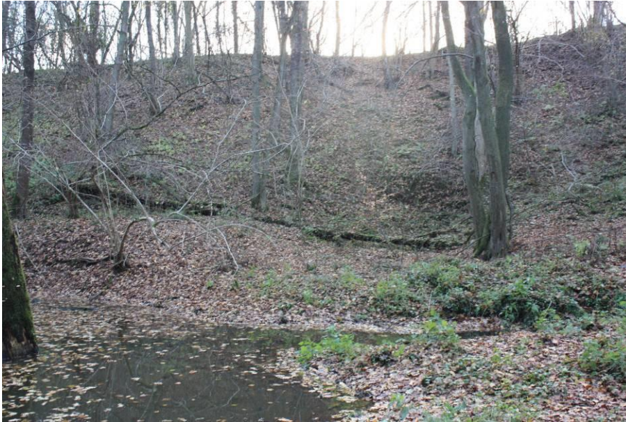
Abbildung 13: Lagepunkt 3 – Verschüttete und kollabierte Kanaldurchführung durch den Bahndamm der SNCB in Höhe der Senke des umgefallenen Baums
