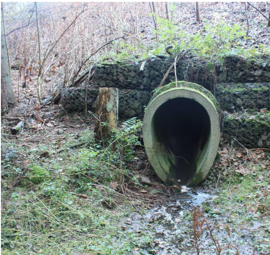
Abbildung 14: Lagepunkt 4 – Kanalaustritt auf der anderen Bahndammseite auf Hergenrather Seite
